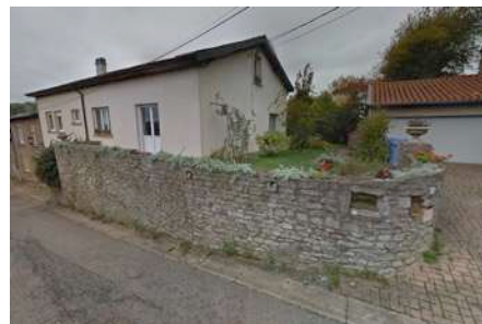
e9. Mur, rue Saint Charles
